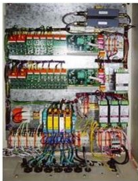
Рис. 6. Размещение аппаратуры регистрации данных и управления в электротехническом шкафу
